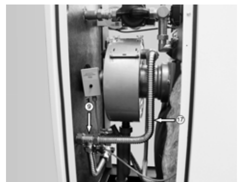
Abb./Fig. 9: Montiertes Wellrohr ⑪ am Rohrausgang Rücklauf Tuyau ondulé monté ⑪ à la sortie du tuyau du retour.
